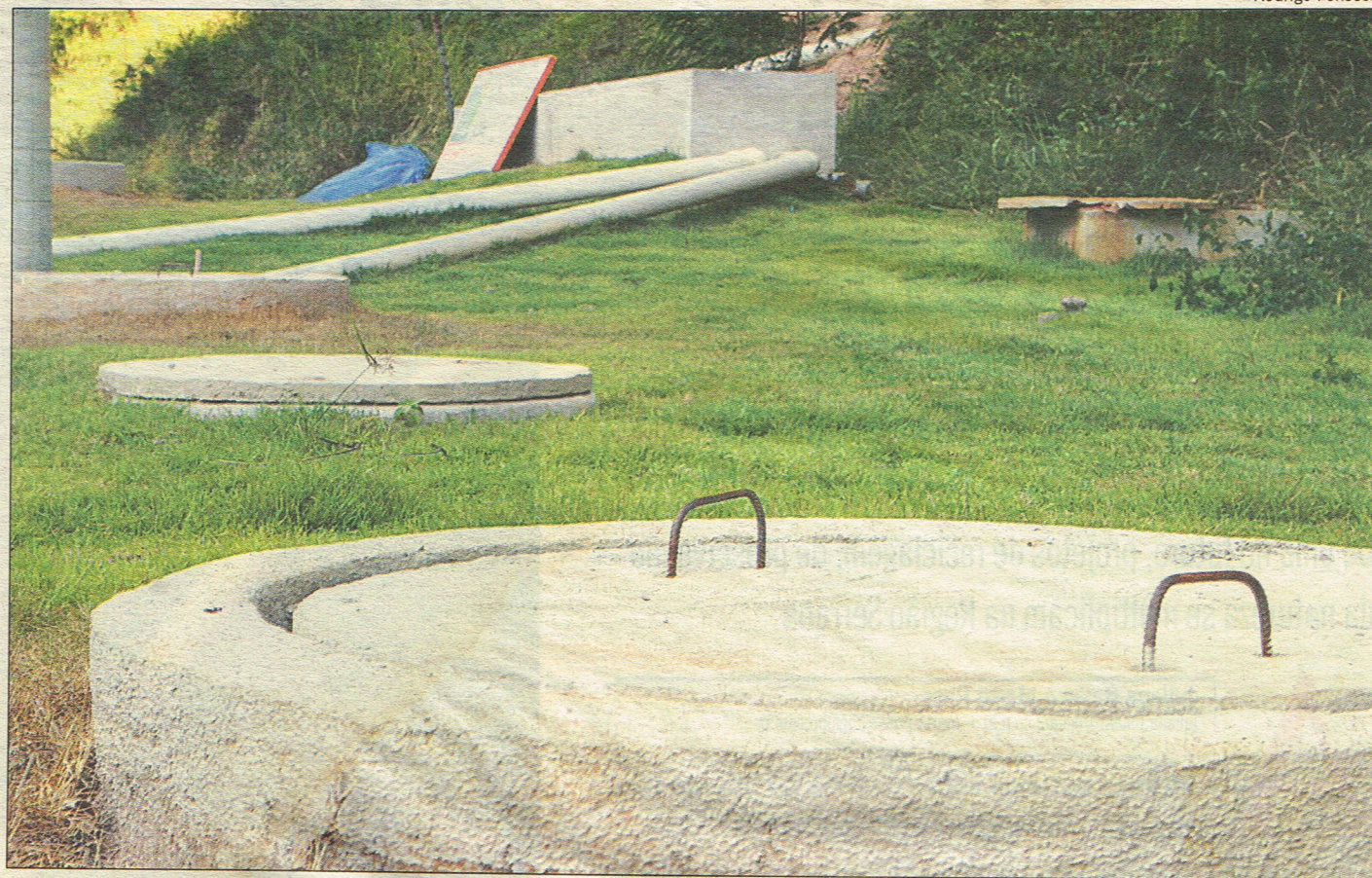
■ EM NOGUEIRA, cerca de mil moradores de Águas Lindas serão beneficiados pelas unidades, equipadas com filtros de garrafas PET recolhidas nos rios de Petrópolis
